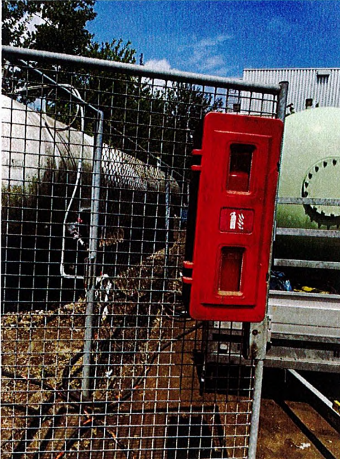
Opstelling ingang met brandblusser
